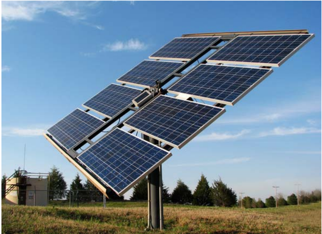
Figura 4: Sistema de paneles solares
