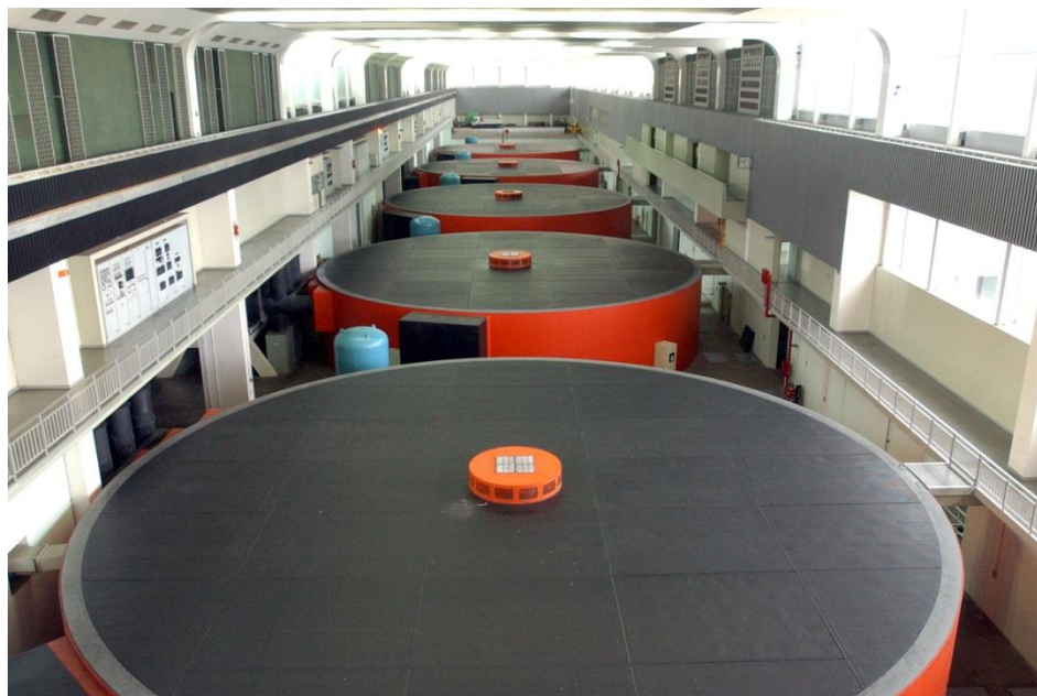
Figura 12: sala de máquinas. (Hidroeléctrica el Chocón, 2015).
