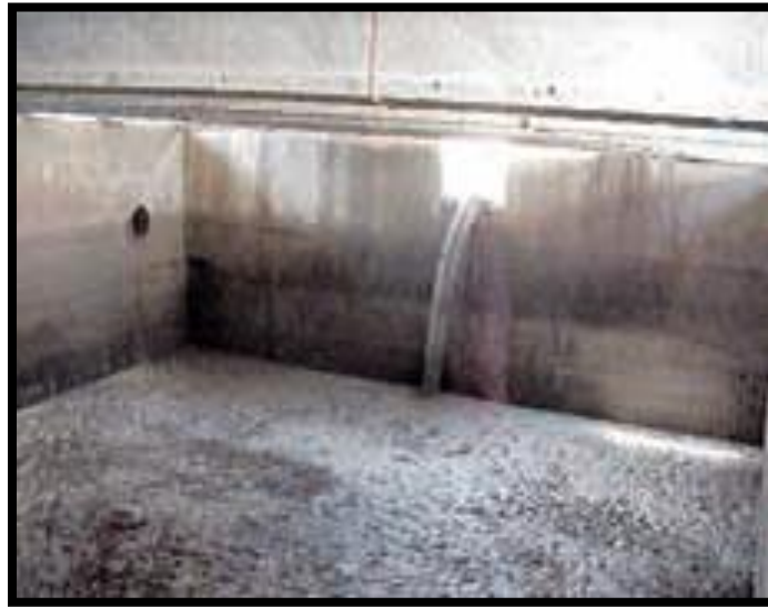
Figura 20: cámara de pre mezcla o alimentación
