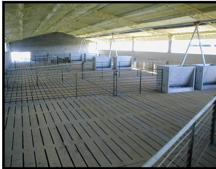
Figura 16: pisos full slats montados
