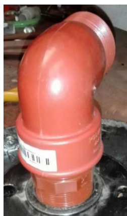
Figura 31: Codos a 90° de ingreso y egreso de agua
