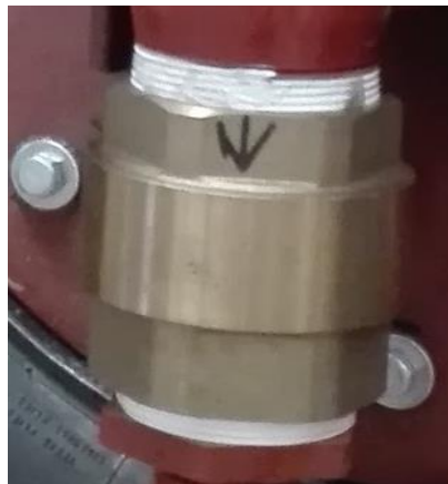
Figura 36: Válvulas de retención
