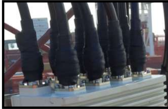
Figura N° 50 Vista de los conectores de RF protegidos con cinta autovulcanizante
