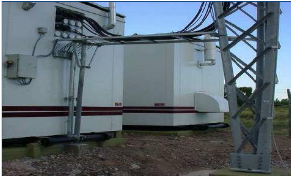
Figura 24 - Bandeja porta Cable hacia el Shelter
