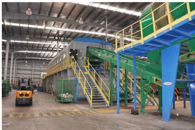
Figura 13: Equipo de tratamiento RSU (1 de 2). Fuente: Informe de Letra P (2016)
