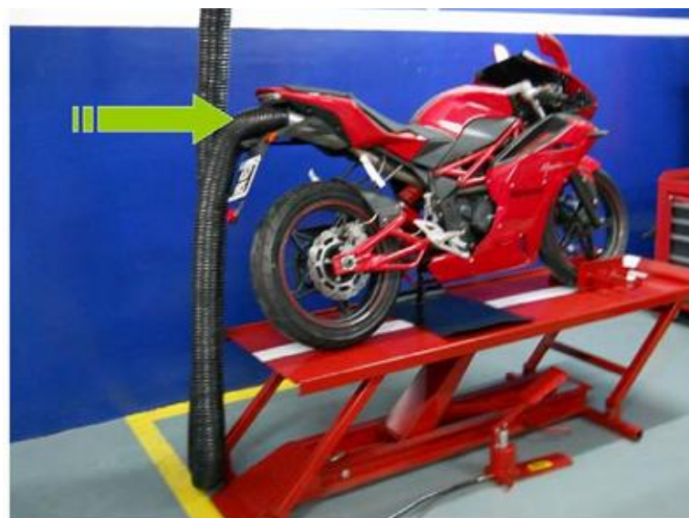
Imagen 43: Ducto de Extracción de Gases.
