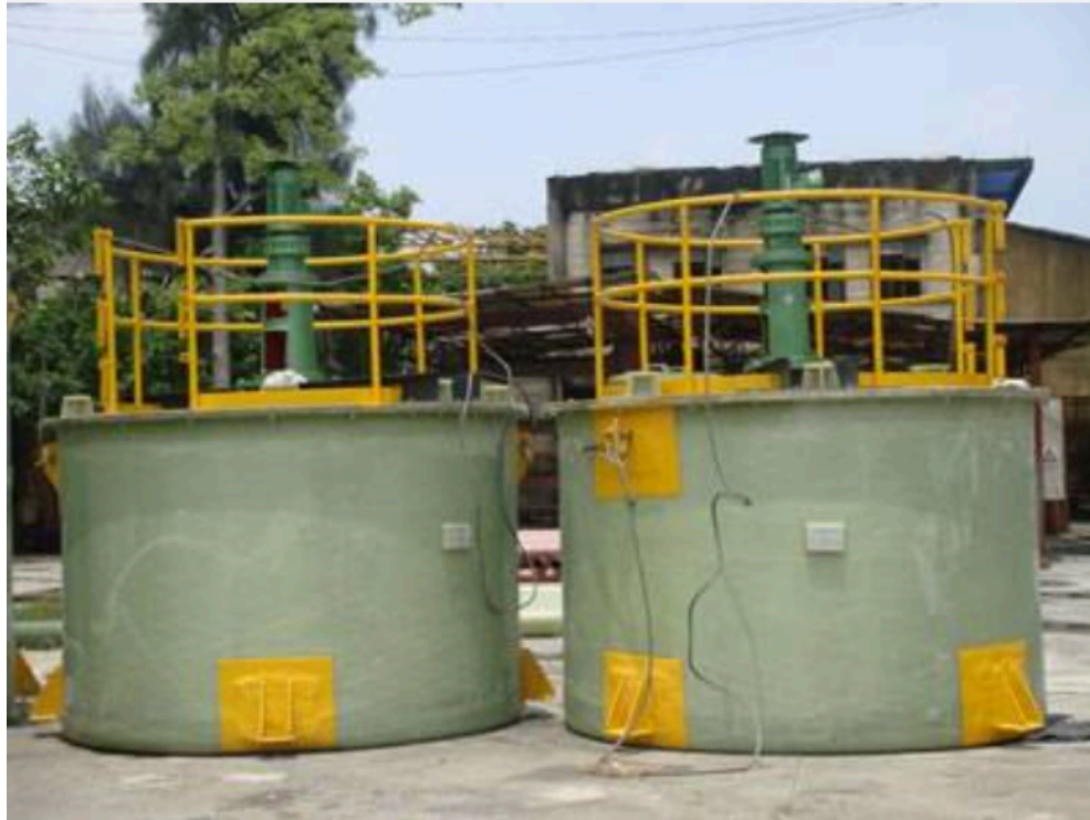
Figura 33: Tanques FRP con agitadores (Fuente: Proveedor "Kaymo").
