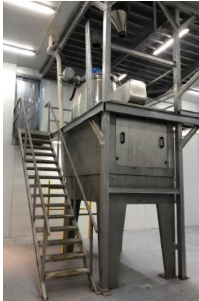
Figura 71: Mezclador Industrial. Fuente: Propia.
