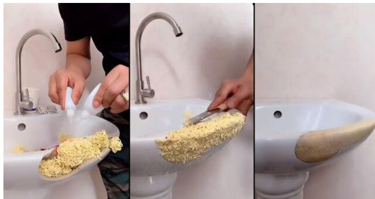
Figura 2 – Fideos instantáneos siendo utilizados para reparar un lavamanos. Fuente: Youtube
